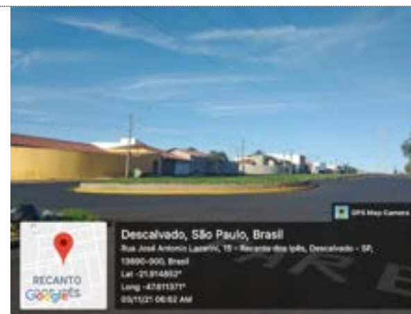
Cenário: Falta sinalização de regulamentação e de advertência
