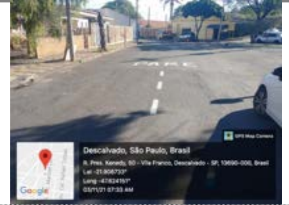
Cenário: Sinalização horizontal fora de padrão
